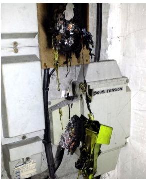
Ce qui reste d'un Linky ayant fondu...ici, par chance, la platine en bois ne s'est pas embrasée.
